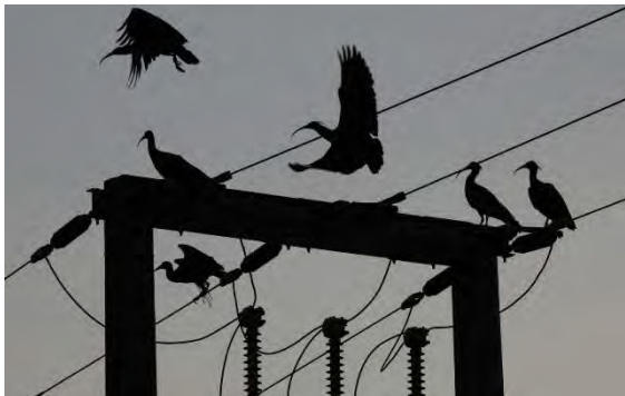
Abb. 10: Ende Juli kamen im Gemeindegebiet von Hochburg-Ach in Oberösterreich innerhalb von zwei Tagen fünf unserer Waldtrappe an einem ungesicherten Masten einer Mittelspannungsleitung um.
