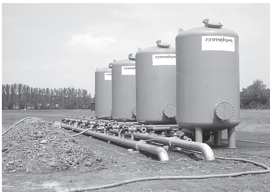
Abb. 2: Temporäre Aktivkohlefilteranlage im Wasserwerk Möhnebogen
